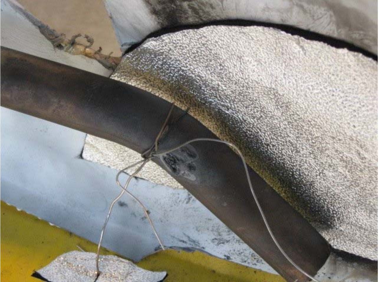
Figura 3 – Punto di misura temperatura tubo (Тн)
